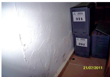
Foto n.º 3957 de 21/07/2011 — Caixas de processo depositadas no piso e sujeitas à umidade
