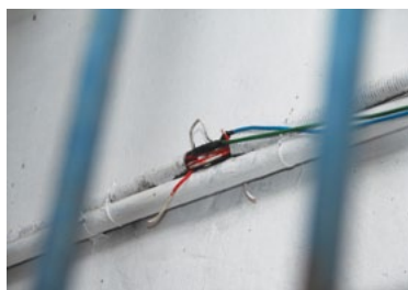
Rede elétrica exposta
