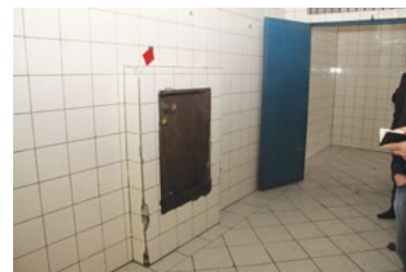
Sistema de incêndio inutilizado (foto modificada – rosto do agente prisional coberto)
