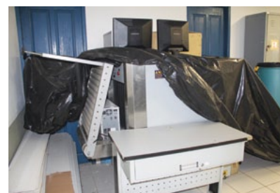
Equipamento de raio-x fora de operação por falta de manutenção e coberto devido às goteiras
