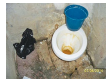
Sanitário de cela da galeria "casa velha"
