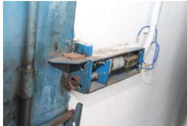
Fechadura de acionamento automático fora de uso por falta de manutenção
