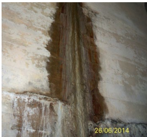
FOTO 5: INFILTRAÇÃO NA GALERIA DE INSPEÇÃO
