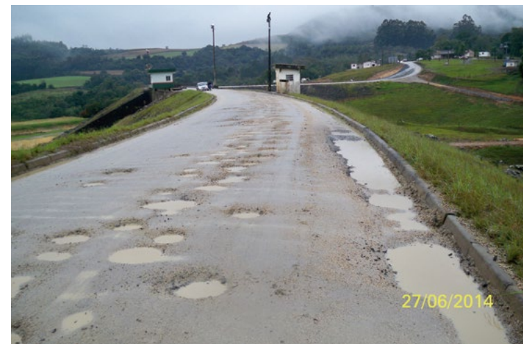
FOTO 3: ACÚMULO DE ÁGUA NO COROAMENTO, AUMENTANDO AS CHANCES DE INFILTRAÇÃO NO CORPO DA BARRAGEM
