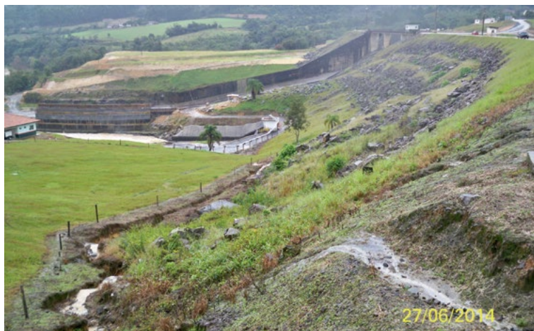
FOTO 4: EROSIÃO CAUSADA PELA FALTA DE REVESTIMENTO E DRENAGEM NO COROAMENTO
