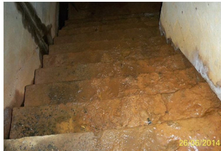
FOTO 6: SURGÊNCIA DE ÁGUA NO CONCRETO DA GALERIA DE INSPEÇÃO DEVIDO A INFILTRAÇÕES
