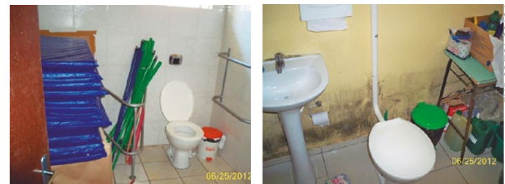
Banheiro utilizado como depósito de materiais. Banheiro utilizado como depósito de materiais e mofo nas paredes.
