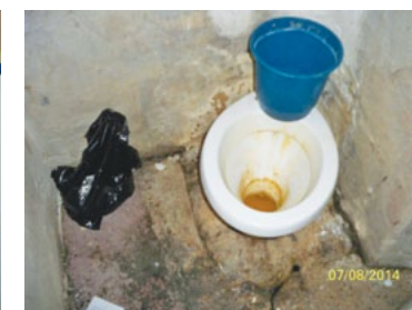
Sanitário de cela da galeria "casa velha"
