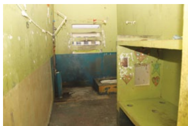
Cela com a pia, chuveiro, ralo e rede elétrica depredados
