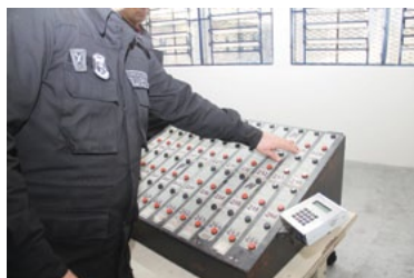
Quadro de acionamento das fechaduras das celas com defeito, somente algumas funcionam
