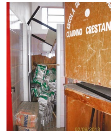
Banheiro utilizado como depósito de materiais diversos na EEB Claudino Crestani.
