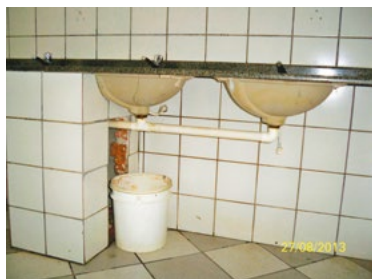
Vazamento em pia de banheiro da EEB Intendente José Fernandes.
