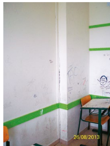
Paredes da sala de aula riscadas, com desenhos e escritos feitos pelos alunos na EEM Antônio Paschoal Apóstolo.
