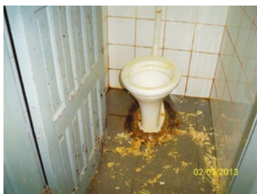
Péssimo estado de conservação do banheiro da EEB Claudino Crestani.
