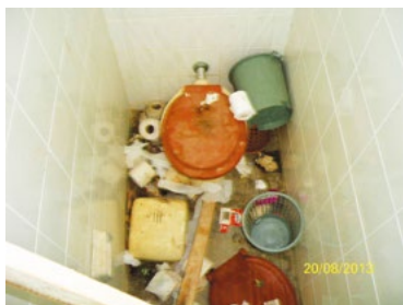
Banheiro interdito e com lixo na EEB Carmem Seara Leite
